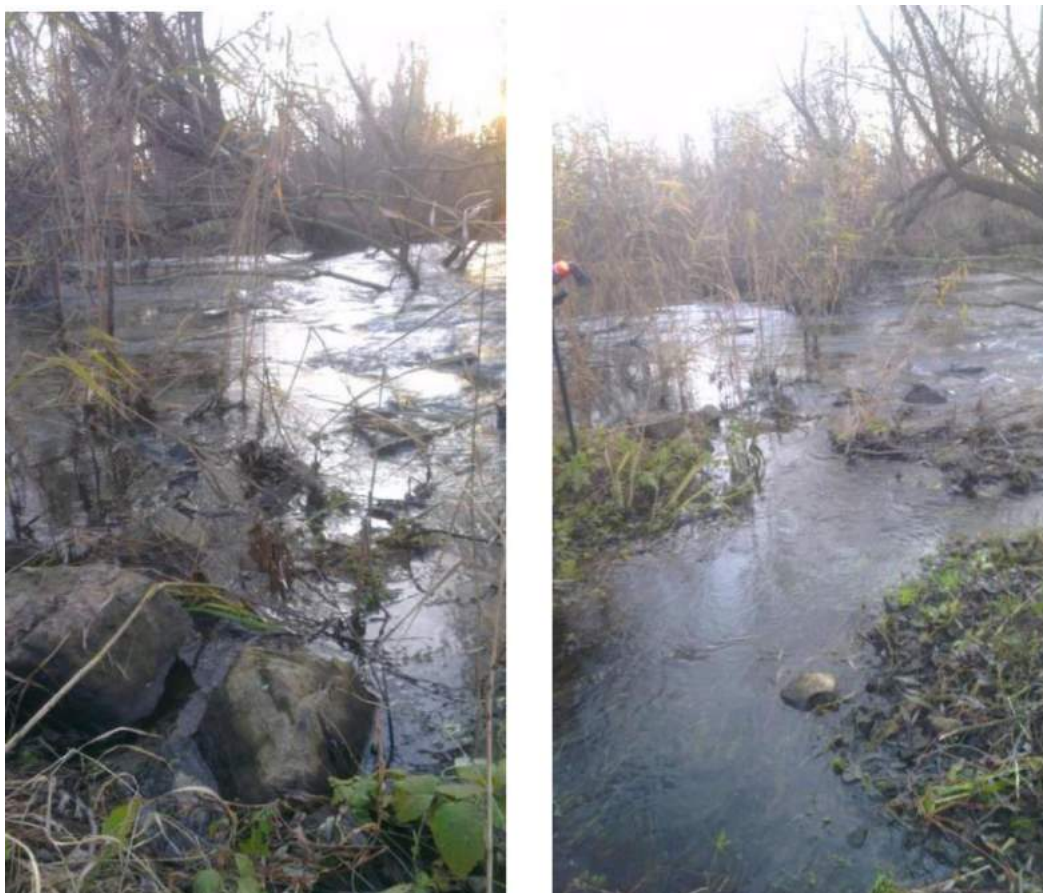
Slika 2.3 Postojeća improvizirana pregrada (Izvor: Idejno rješenje)
